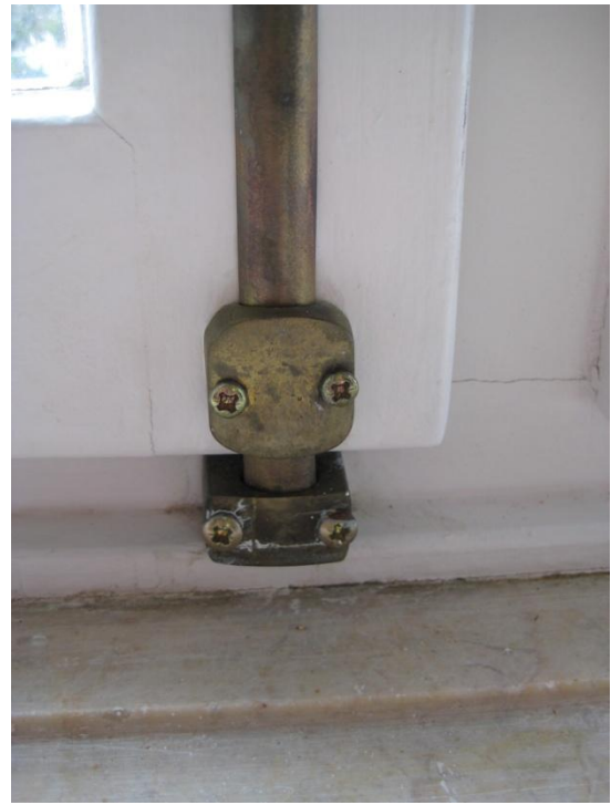
2- Ferragem de fecho inoperante em janela de madeira recuperada (cf. Pontos 2.7.2.1 e 2.7.7.1).
