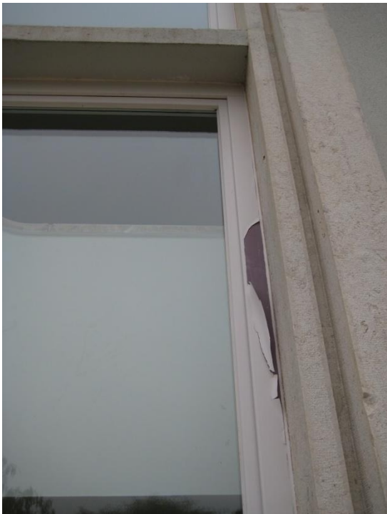
23- Destacamento das pinturas nas caixilharias exteriores de madeira (cf. Pontos 2.7.2.1 e 2.7.7.1).
