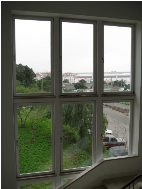
11- Empeno (corrigido com cunhas) em caixilharias exteriores de madeira que foram alvo de recuperação (cf. Pontos 2.7.2.1 e 2.7.7.1).
