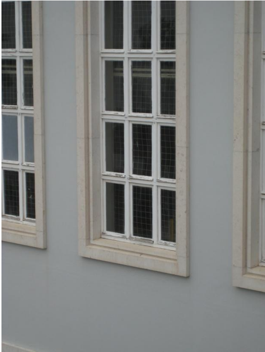
9- Destacamento das pinturas nas caixilharias exteriores de madeira que foram alvo de recuperação (cf. Pontos 2.7.2.1 e 2.7.7.1).
