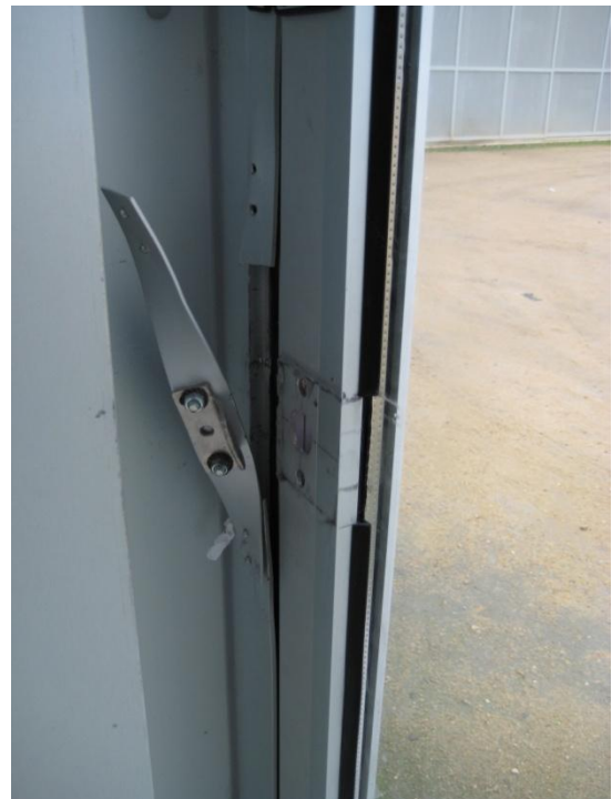
4- Ferragem danificada em caixilharia de alumínio (cf. Ponto 2.7.2.1).
