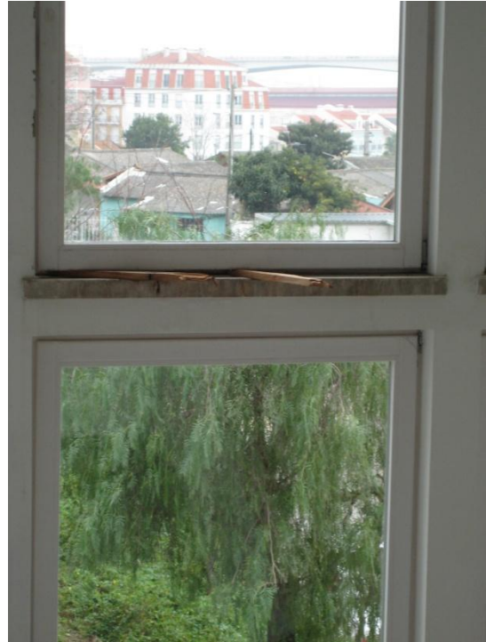
10- Empeno (corrigido com cunhas) em caixilharias exteriores de madeira que foram alvo de recuperação (cf. Pontos 2.7.2.1 e 2.7.7.1).
