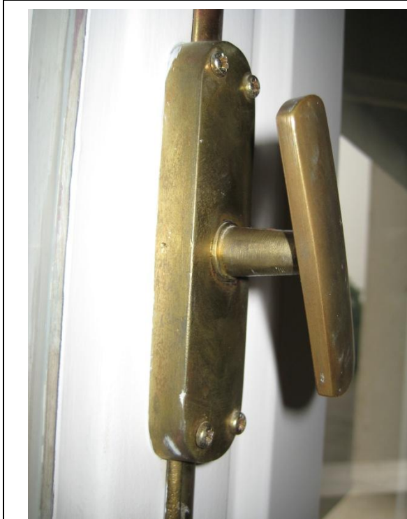
1- Ferragem de fecho inoperante em janela de madeira recuperada (cf. Pontos 2.7.2.1 e 2.7.7.1).
