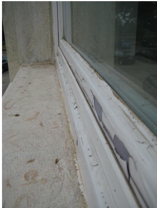
24- Destacamento das pinturas e empeno nas caixilharias exteriores de madeira (cf. Pontos 2.7.2.1 e 2.7.7.1).
