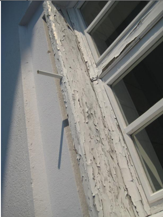
27 - Vãos exteriores em madeira - destacamento da pintura no peitoril e nas folhas móveis.
