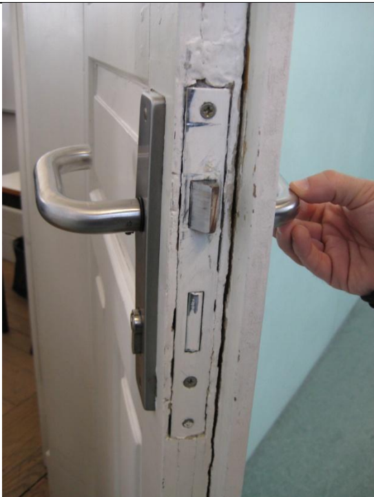
11 - Carpintarias interiores - mau acabamento na zona da fechadura e batente.
