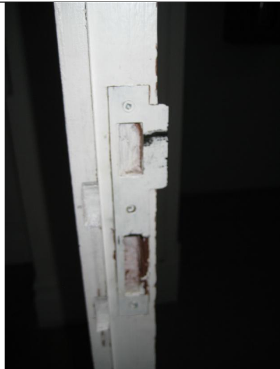
12 - Carpintarias interiores - ferragens pintadas e pintura deficiente com emendas.
