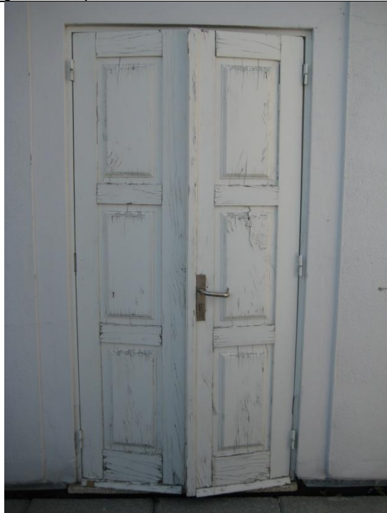
28 - Vãos exteriores em madeira - destacamento da pintura, empenos e fissuração nas juntas.
